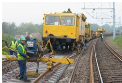
Longs Rails soudés sur traverses béton
